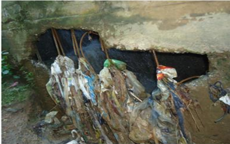
Foto Daños Box Couvert Quebrada Hospital
