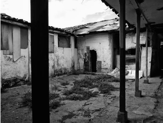
Fotografía 33 - Primer patio casa Jesús Irigorri construida a inicios del siglo XX, nótese el deterioro, actual. Calle 13A. N.º 11-35. Apolinar Ruiz López.
