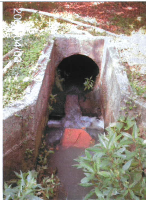
Fotografía 10. Sistema de captación y derivación de agua.
