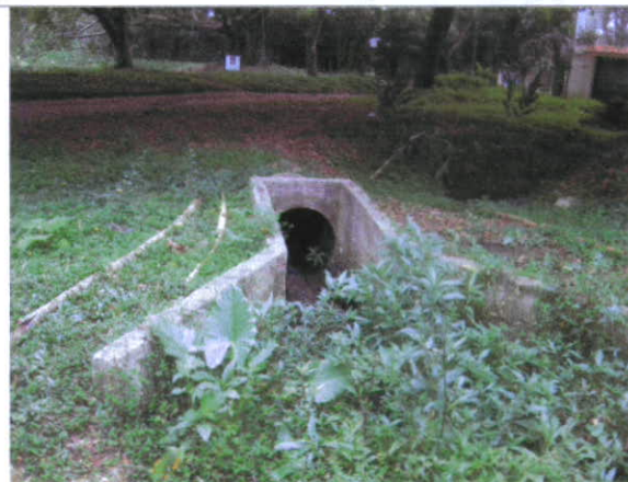
Fotografía 8. Estructuras para el control de las aguas de escorrentía hacia el reservorio.
