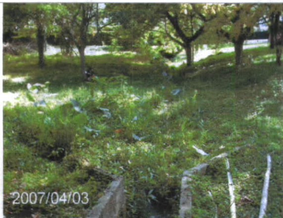
Fotografía 7. Desviación de las acequias hacia una caja colectora para control de escorrentía.
