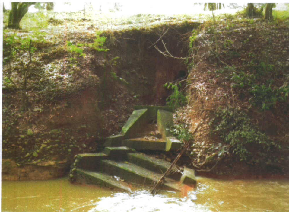
Fotografías 3-12 y 3-13 Cabezales de descargas de alcantarillado pluvial ubicados entre las avenidas Pasoancho y Cañasgordas, destruidos por socavación
