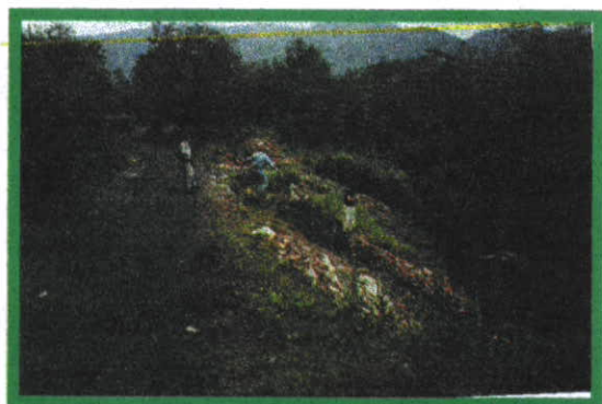
R2F12. Hundimiento de la banca de la vía a la Escuela de Carabineros. Se observa una alto deterioro ambiental, debido a la utilización del sector como escombrera, lo cual se traduce en una amenaza para los asentamientos aguas abajo.
