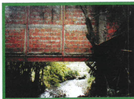
R3F36. Algunas obstrucciones sobre el cauce como la que se presenta en la foto aumentan las posibilidades de represamiento del flujo en el caso de una avenida torrencial. Los caudales debido a dicho fenómeno podrían incluso hasta superar los generados por una avenida máxima.
