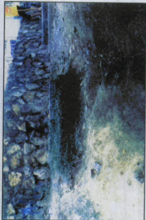
Foto 4: Ampliación del sitio afectado.
