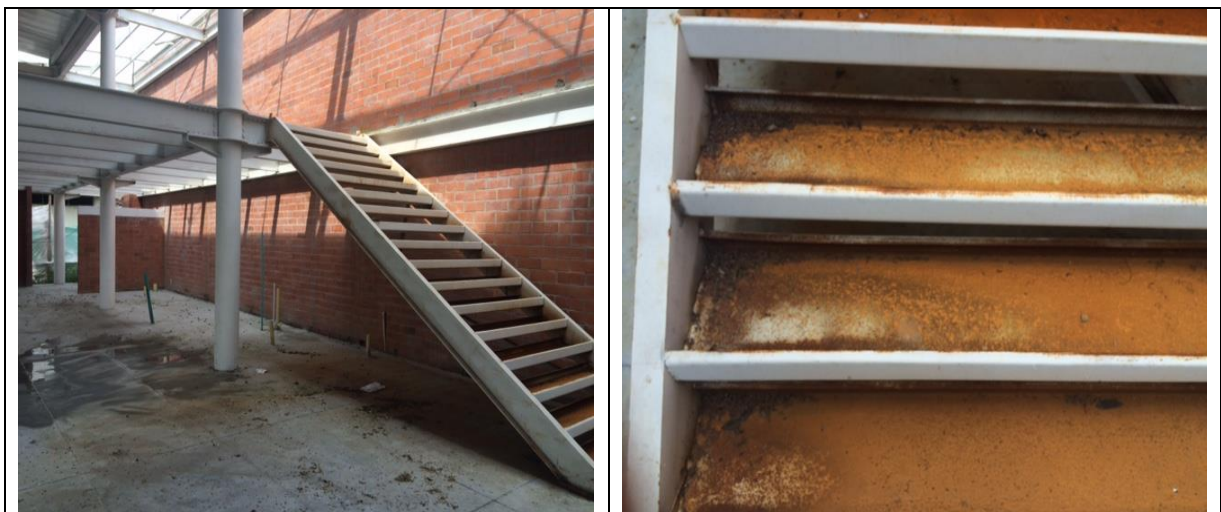
Imagen 3. Escaleras y peldaños sin concreto
