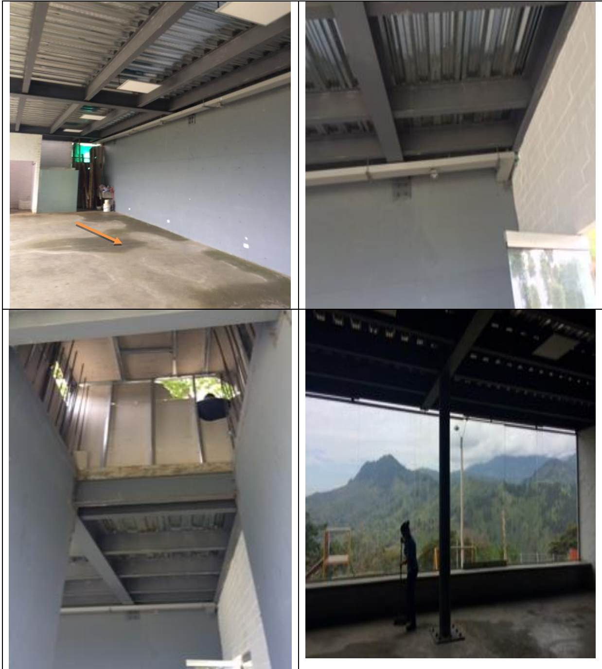
Imagen 3. Humedades en el piso por lluvias, foso del ascensor y ventanales
