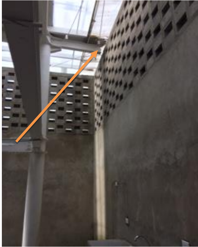
Imagen 4. Teja de policarbonato deteriorada
