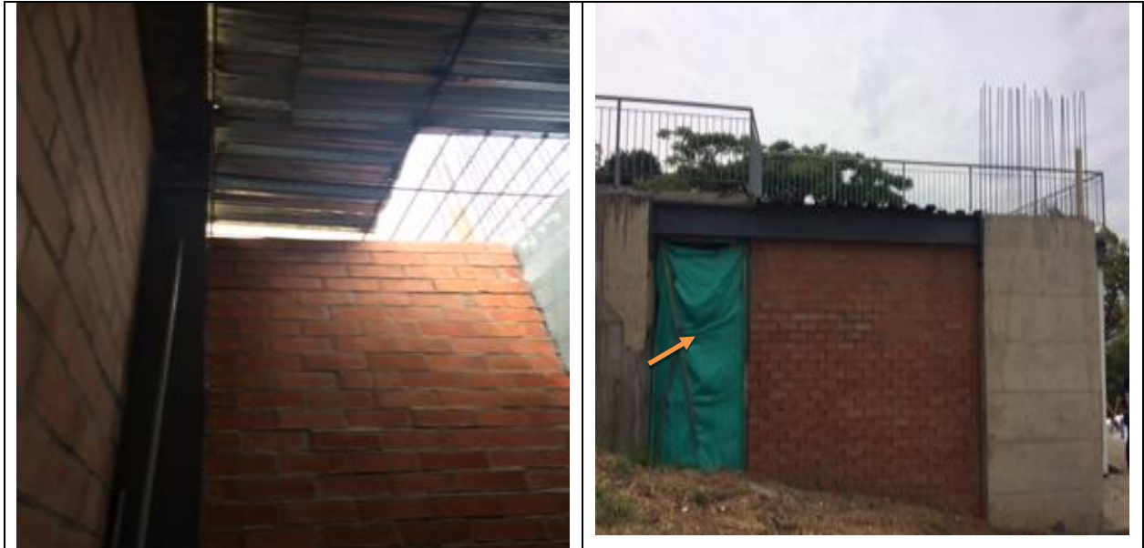
Imagen 5. Espacio a cielo abierto del primer piso y ventana rota con cerramiento en polisombra
