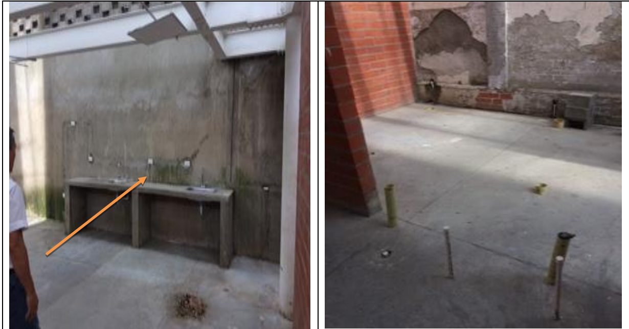
Imagen 2. Humedad en el muro de lavaplatos y pases hidrosanitarios
