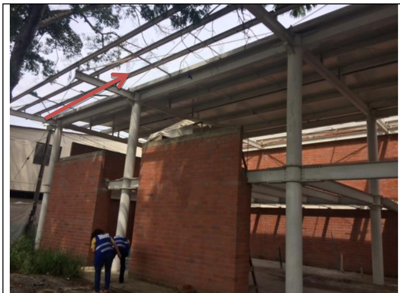
Imagen 4. Cubierta sin teja en termo acústica
