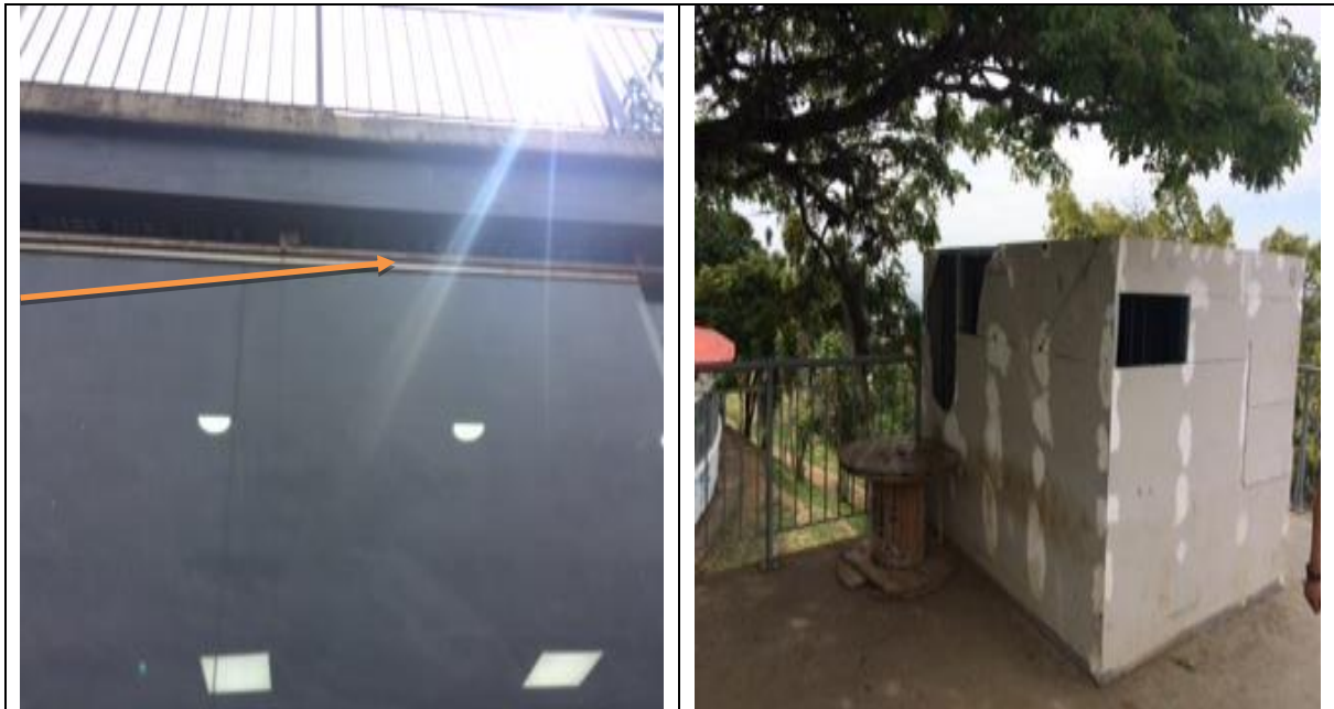
Imagen 6. Oxidación en la estructura de las ventanas y panel roto del foso del futuro
