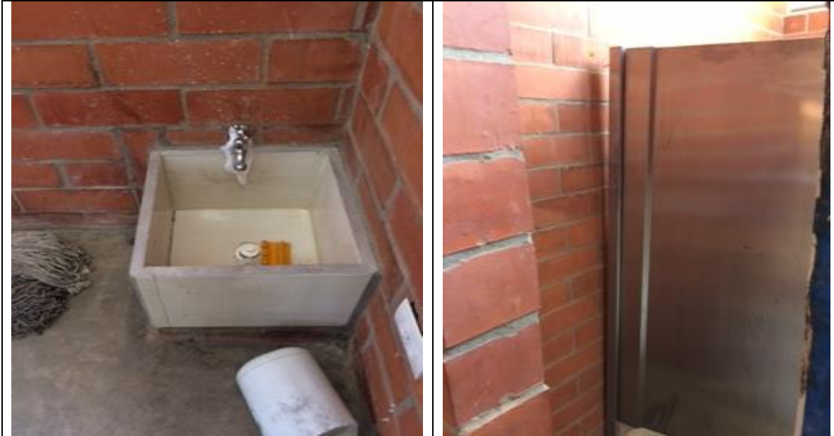
Imagen 5. Daños en lava traperos y puerta de baño
