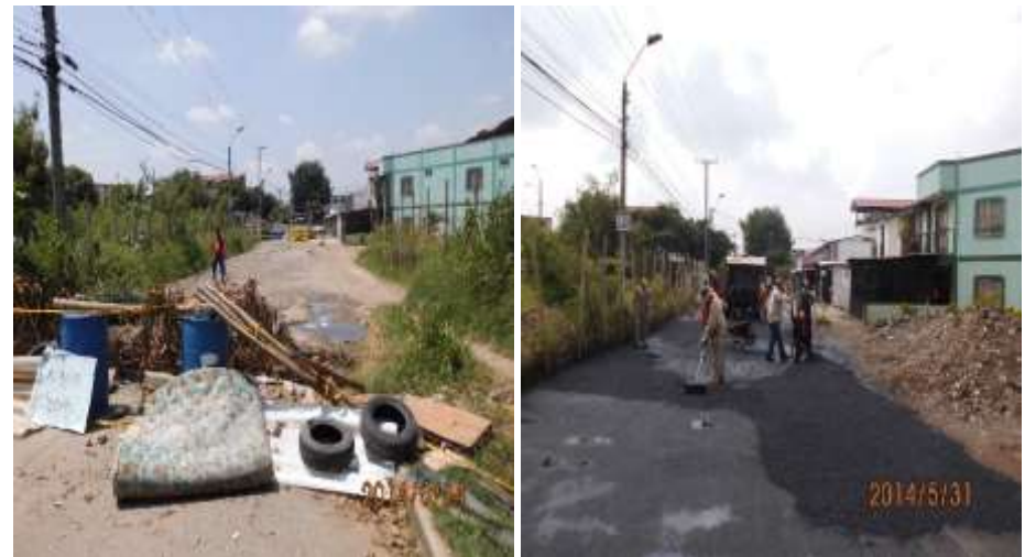
Calle 73N Av. 2B- Foto: Grupo Operativo S.I.V- Barrio Brisas de los Álamos
