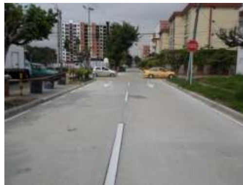
Avenida 2B N entre calles 32 N y 34 N Fuente: Ing. Carmen Stella Gómez S.I.V
