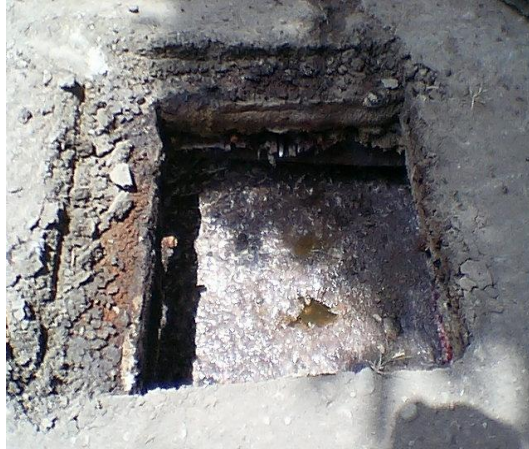
Pozos sépticos colmatados sin Mantenimiento alguno.
