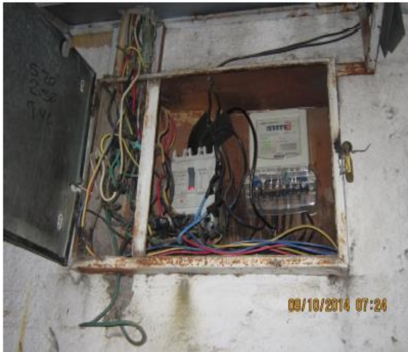
1. CAJA EN LA QUE SE ENCONTRABA EL MEDIDOR DE ENERGÍA ACTIVA Y SU RESPECTIVO BREAKER TOTALIZADOR PRINCIPAL
